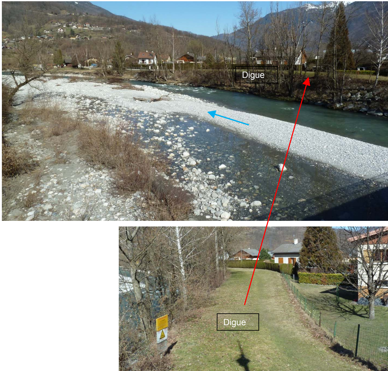
Figure 12 : Photos en aval du pont routier de Cevins – digue en rive droite
