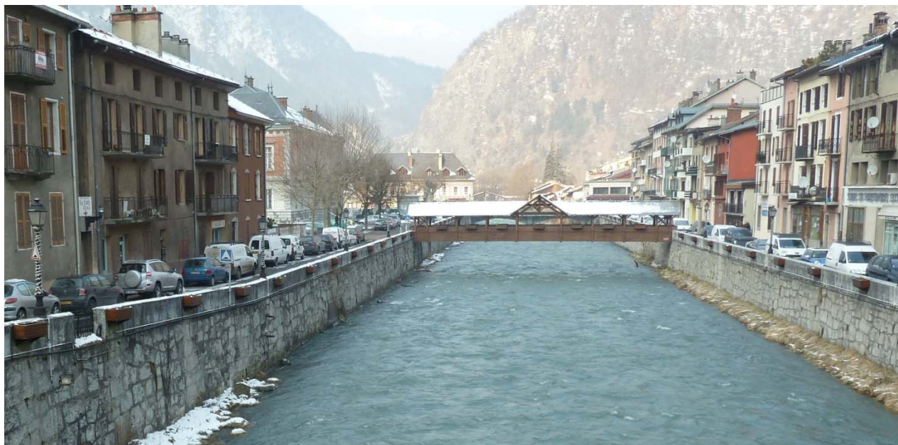
Figure 14 : Photo de l'Isère dans la traversée de Moûtiers – mur digue – enjeux importants
